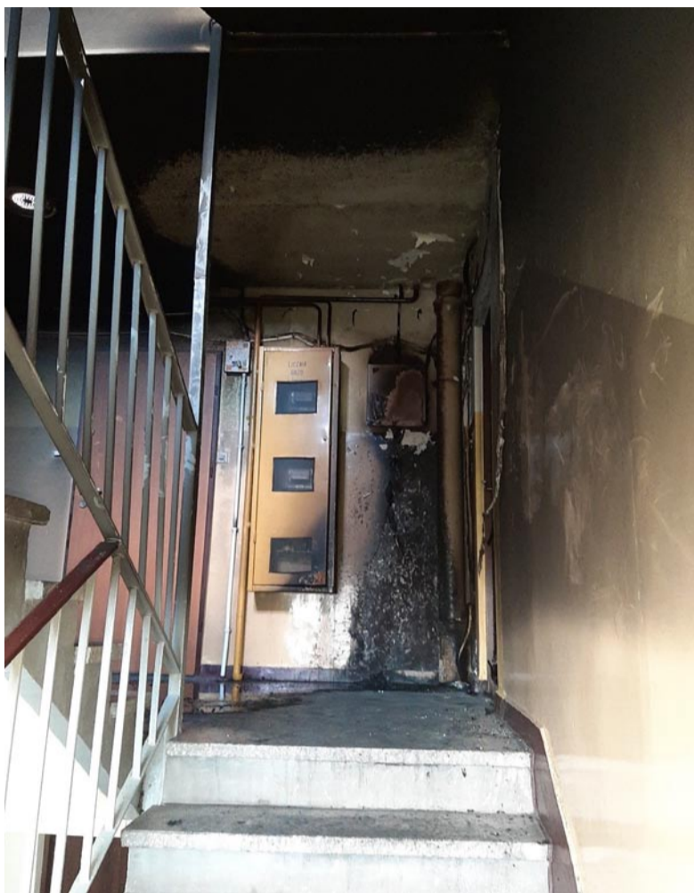
Pożar na klatce schodowej w budynku przy ul. Radockiego 118 (2021 rok).
