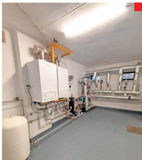
Nowa kotłownia przy ul. Żurawiej 43. Nowe kotłownie powstały również przy ul. Poprzecznej 2a-2c, 4a-4c, 18-18a, 20-20b oraz ul. Jaworowej 36-36b.
